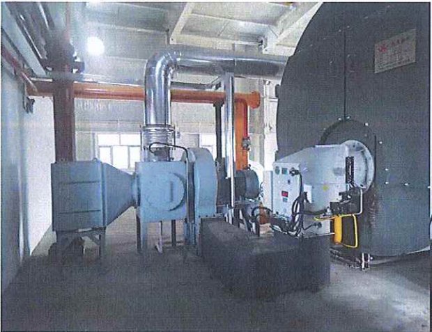
锅炉+低氮燃烧器
