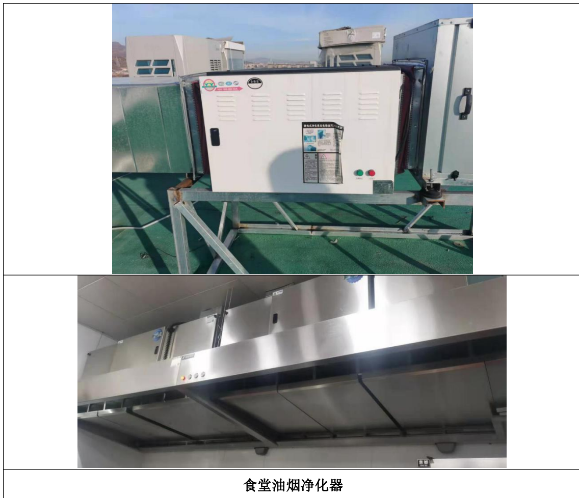
图 3.2-3 废气处理装置现场照片
