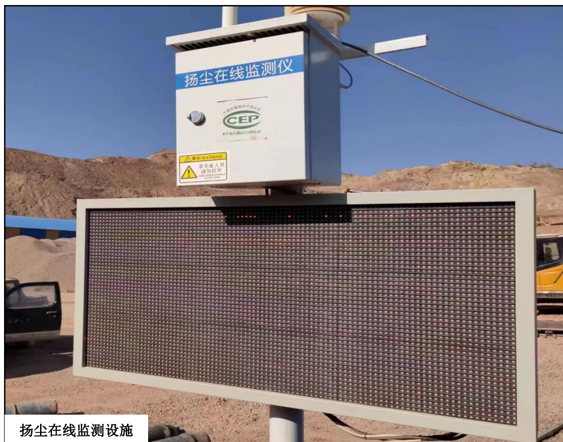
扬尘在线监测设施
