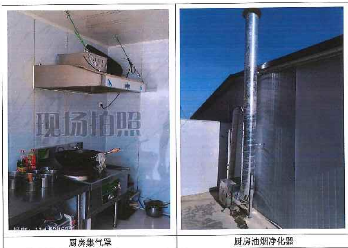
图 3-2 废气处理装置现场照片
