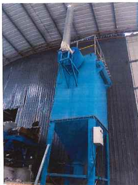
碎石工艺筛分废气除尘器+15 米高排气筒 (3#)
