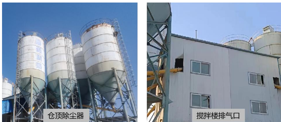
图 3-1 项目除尘设施照片
