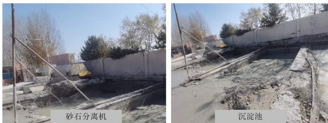
图 3-3 项目沉淀池照片
